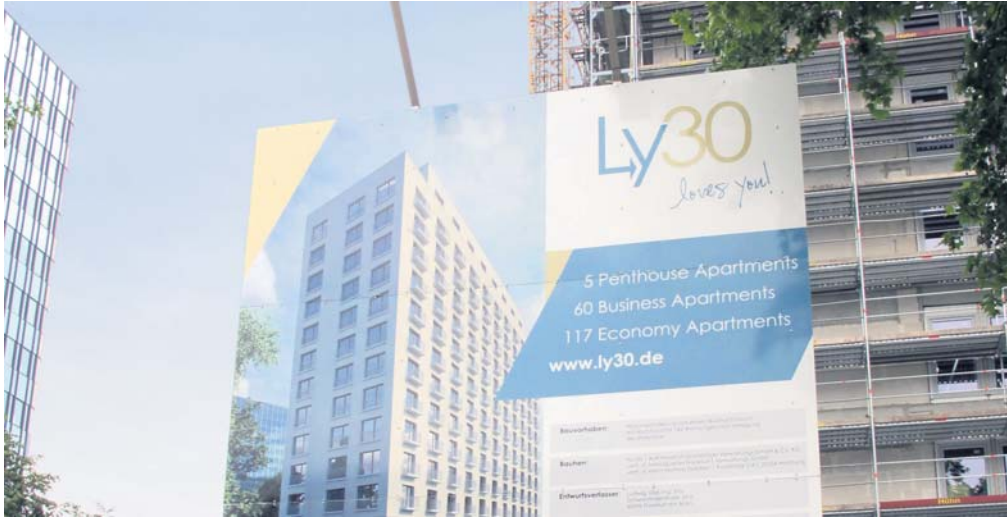
Jetzt wird wieder in die Hände gespußt: In Niederrad baut der Asset-Manager AviaRent ein leeres Bürohaus zu einer Wohnanlage um. Auftraggeber ist ein von AviaRent gemanagter Fonds. Bild: apf
